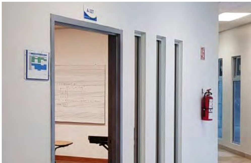
Figura 85. Falta de señalética accesible en el CUDA
