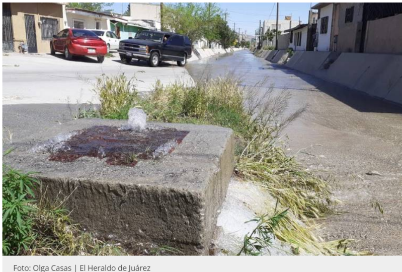
Figura. 1. Fuga de agua potable en la Col. Juárez, Cd. Juárez Chih. Fuente: (Valenzuela, 2020)
