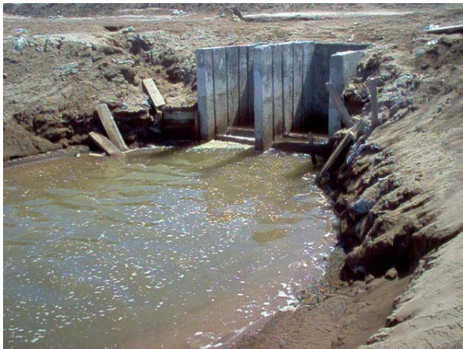
Fig. 18. Detalle de estructura de desagüe en una de las granjas locales. Se observa deterioro del bordo.
