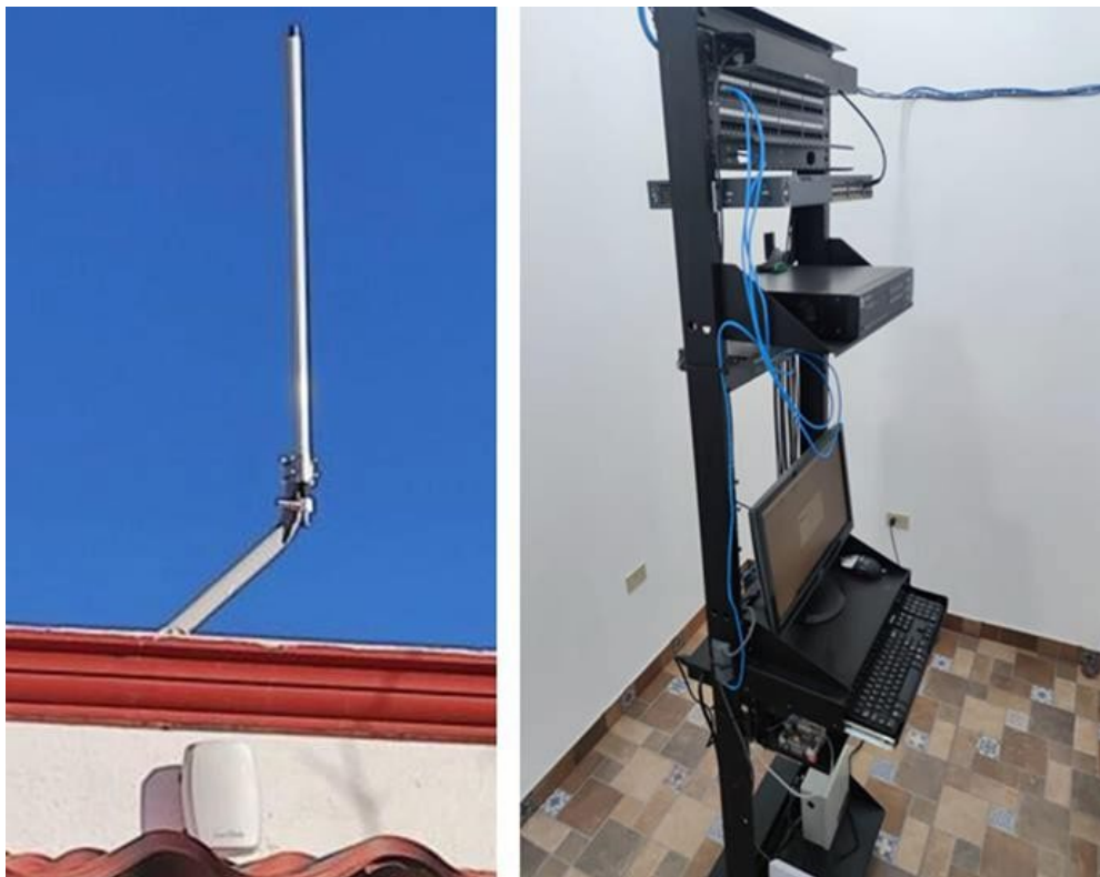
Figura 11. Izq. Equipo de enlace a la antena Gateway - Der. Centro de cómputo para transferencia de datos CeTraTecIA (Archivo: Granados Olivas, 2023)
