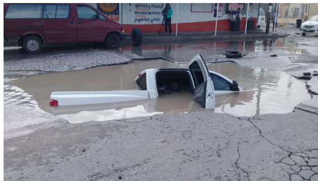
Figura 1.2: Lluvias causaron daños mayores en una camioneta propiedad de una ciudadana que transitaba por la calle.
