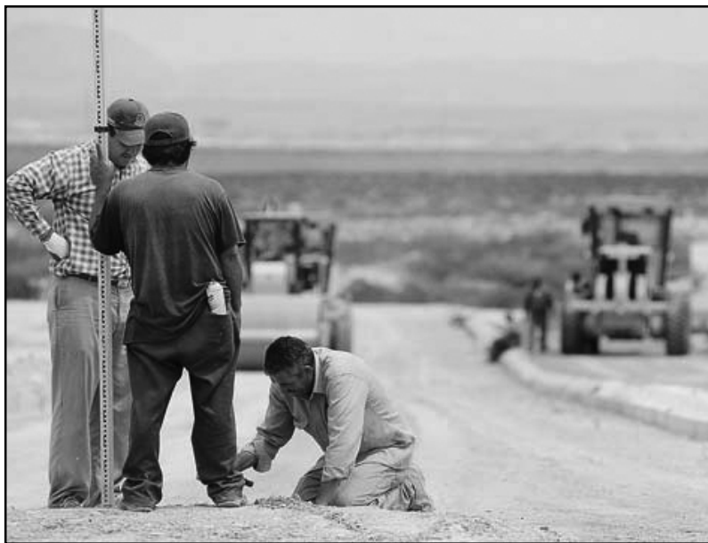
Las obras de construcción de la ciudad universitaria iniciaron este año y se planea tener la primera etapa a finales de 2010.
