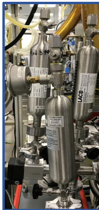
Figura 3.17. Sistema con implementación de nueva botella de verificación
