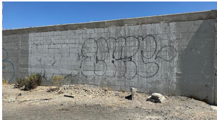
Figura 133. Elementos de contaminación visual, tramo 3, lote baldío y grafiti
