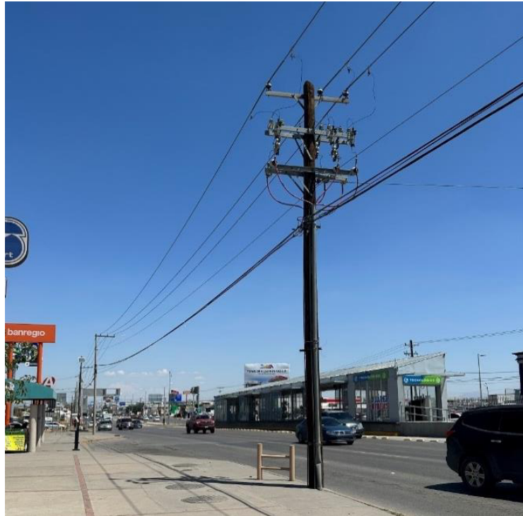
Figura 129. Elementos de contaminación visual, tramo 2, postes, cableado y banquetas
