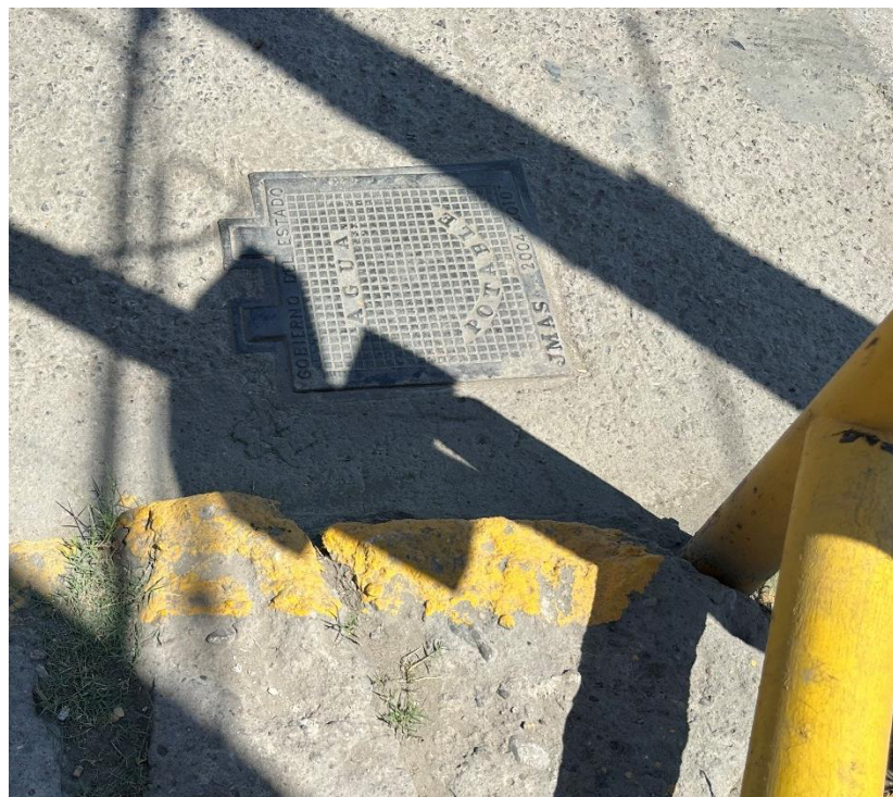
Figura 125. Elementos de contaminación visual, tramo 2, banqueta
