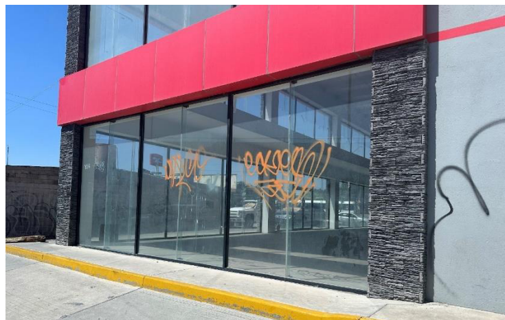
Figura 141. Elementos de contaminación visual, tramo 3, fachada deteriorada y grafiti
