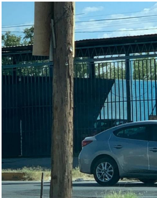
Figura 28. Poste de madera en mal estado físico
