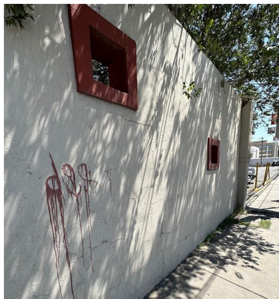
Figura 114. Elementos de contaminación visual, tramo 1, fachada deteriorada
