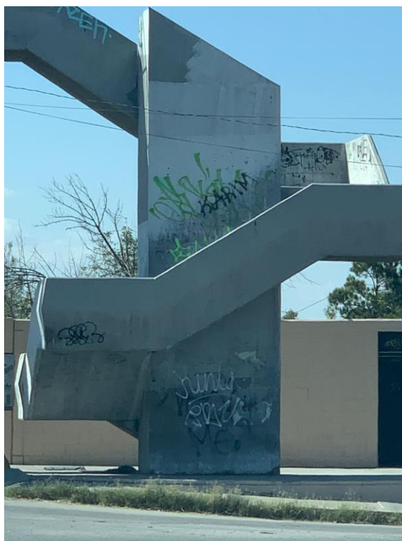
Figura 32. Puente peatonal en deterioro
