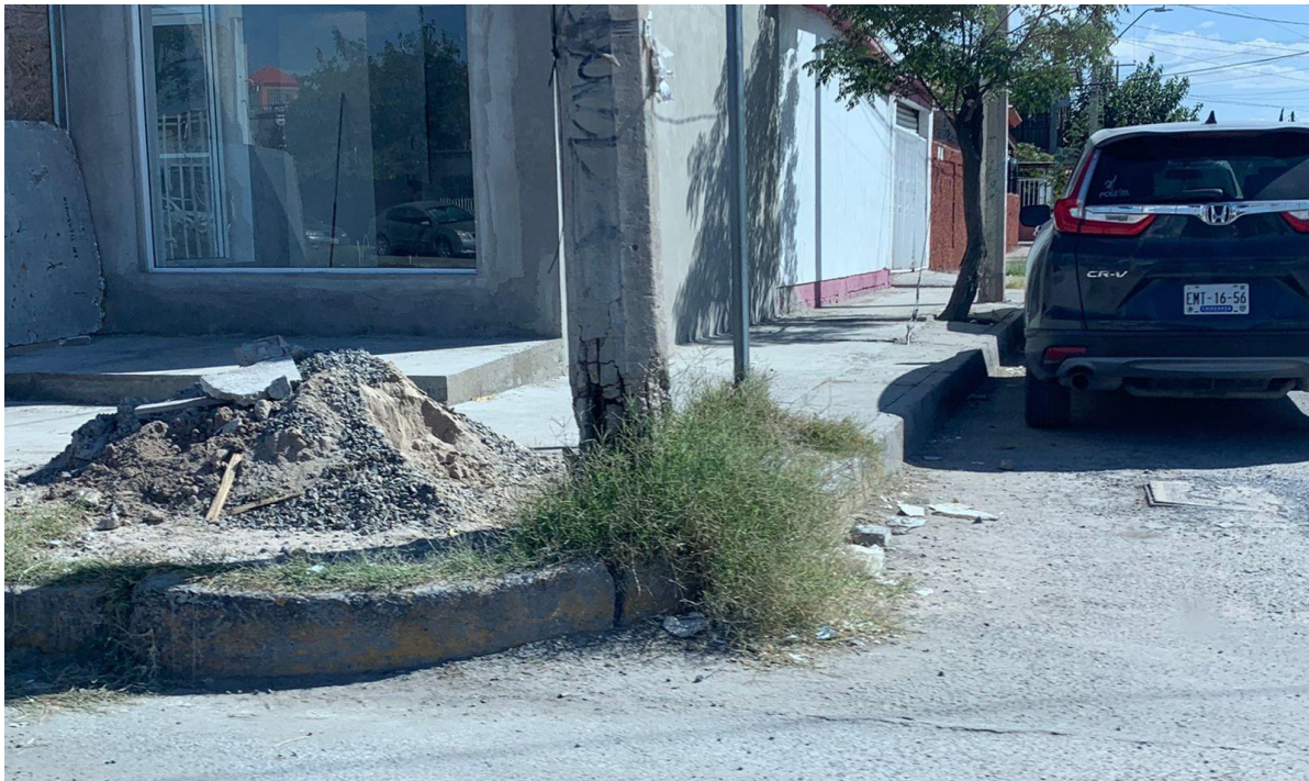
Figura 29. Banquetas en mal estado
