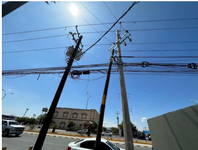
Figura 110. Elementos de contaminación visual, tramo 1, cableado
