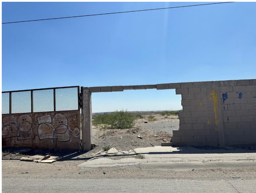
Figura 147. Elementos de contaminación visual, tramo 3, grafiti, edificaciones en estado de deterioro y terreno baldío
