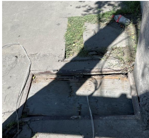
Figura 115. Elementos de contaminación visual, tramo 1, banqueta deteriorada
