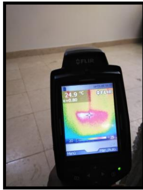
Imagen 30 imagen donde se muestra el muro a estudiar y la cámara térmica arrojando resultados. Imagen propiedad del autor.
