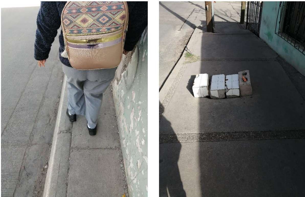
Imagen 2. Colonia Gustavo Díaz Ordaz. A la izquierda se visualiza la estrecha banqueta, y a la derecha la falta de tapadera de registros.
