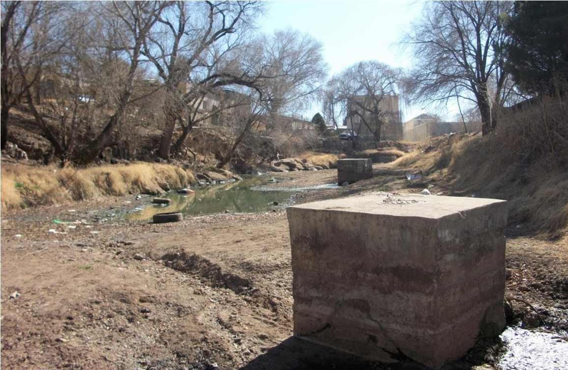
Figura 19 Drenaje expuesto en el corazón de la ciudad Fuente: elaboración propia.
