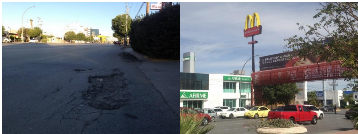
Figura 43: Zonas de carril ciclista con daños en la carpeta asfáltica aunado a la presencia de vegetación y publicidad como contaminación visual.
