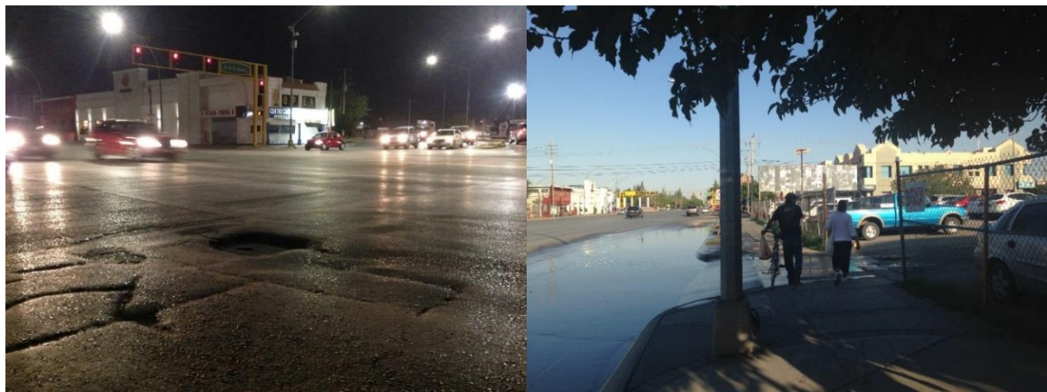
Figura 41: Hoyos y grietas a nivel de calle y zonas de carril ciclista propensas a encharcamientos.
