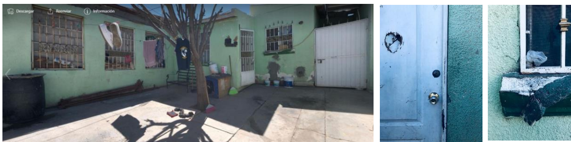
Figura 50. Indicadores de deterioro en la vivienda. Caso de estudio I. Fraccionamiento Torres del Sur. Ciudad Juárez Chihuahua, México. Por: Oscar Burrola, 2019.
