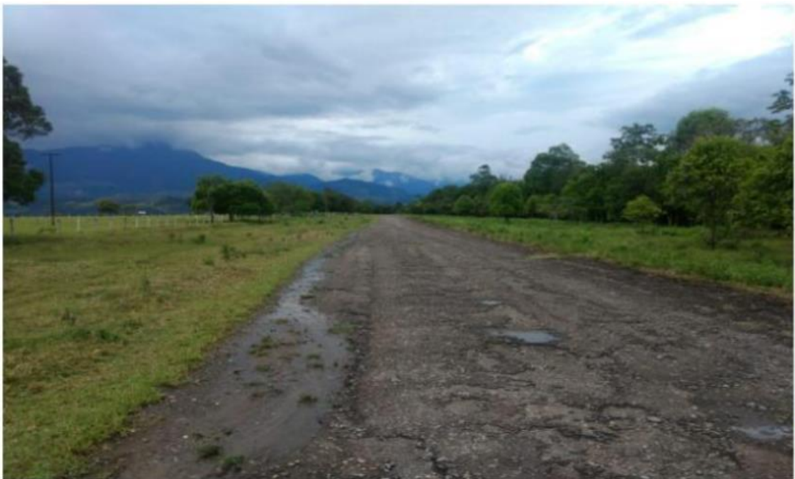
Figura 1.2 Pozos de agua en el manto asfáltico [4].
