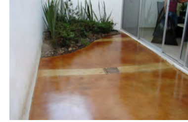
Concreto Pulido Oxidado
