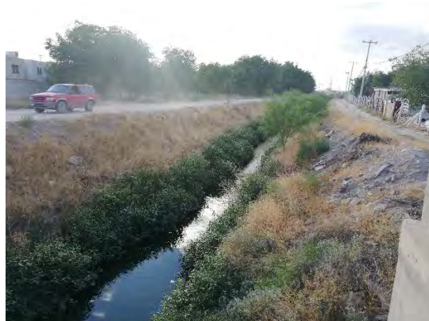
Fotografía 2 Dren 2A. Fuente: Elaboración Propia
