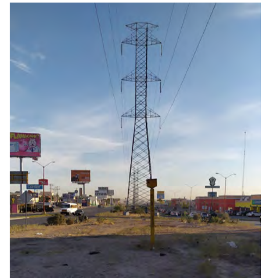
Imagen 5: Torre eléctrica. Foto Propia
