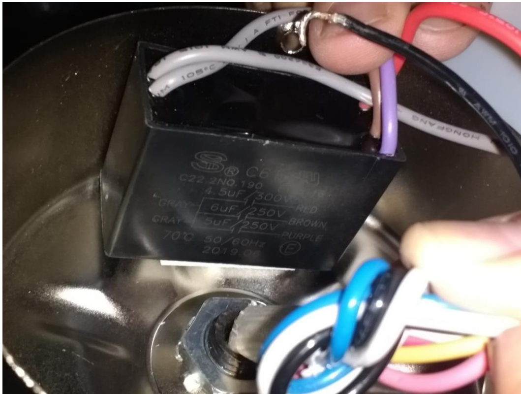
Figura 3.11: Capacitor del motor Fuente: Elaboración propia.
