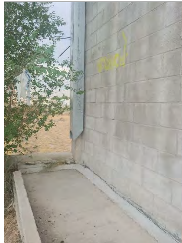
Infraestructura pluvial de COPROFESA Fuente: Elaboración propia, 2020
