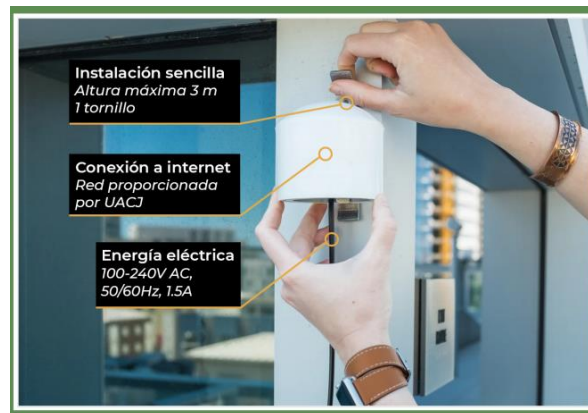
Figura 23. Instalación de dispositivo PurpleAir.
